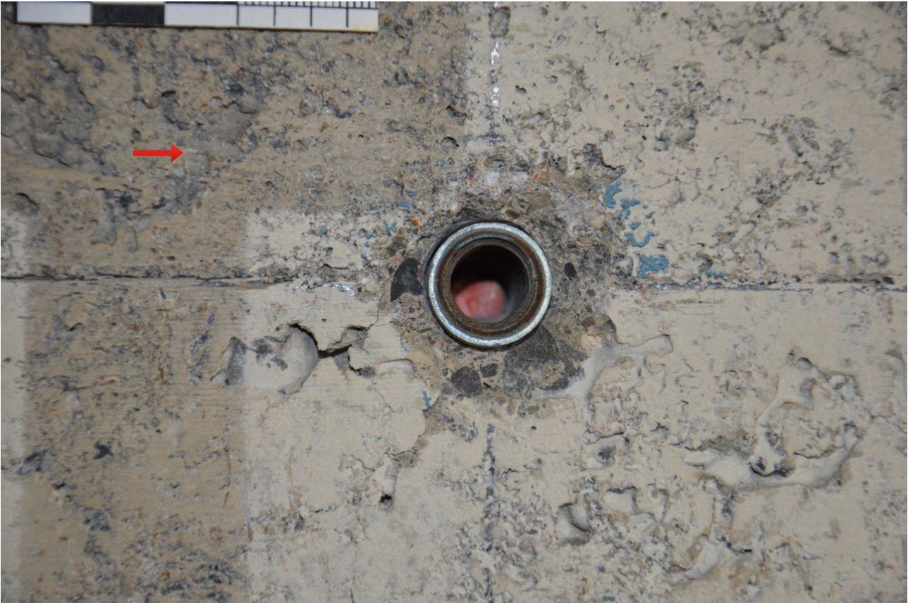
In den Vertiefungen der Wandoberfläche liegen Reste der lila-grauen Lasurfarbe.
